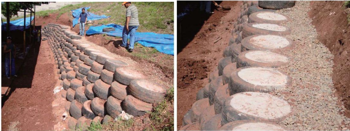
Imagen 14 Muro de contencion Escuela Primaria Emmanuel
